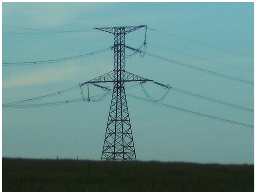
Abbildung 3-1: Beispiel für eine Einsystem Freileitung (380 kV)
